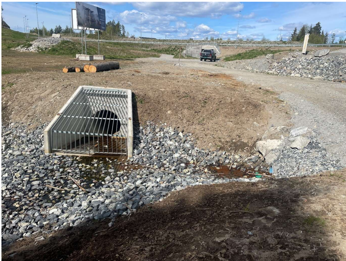
Figur 6 - DN1000 BTG OV-ledningen som ble etablert i forbindelse med omkjøringsveien. Ledningen er etablert iht. VA-rammeplanen [9], men mangler en reguleringsordning for påslipp.
