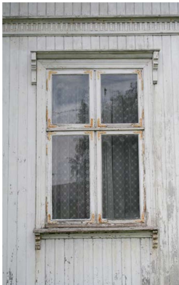
Originalt sveitserstilsvindu. Gode materialer og god håndverkerutførelse har gjort at dette vinduet så langt har hatt en levetid på nær 100 år. Å sette et slikt vindu i stand er bedre enn å skifte ut. Med gode varevinduer er også energioptimeringen bedre enn for nye vinduer. Foto Ola H Fjeldheim, Ullensaker kommune
